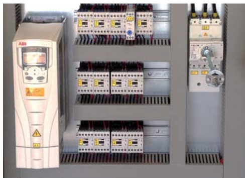
Variateur de fréquences installé dans l'armoire de commande
