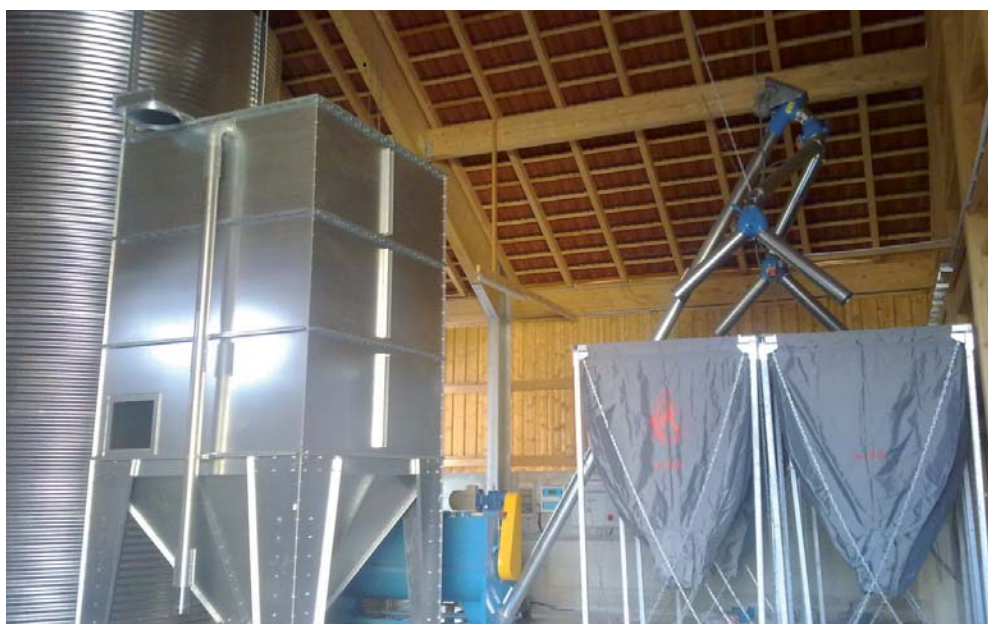
Silo rond, boisseaux et silo textile résistant aux UV
