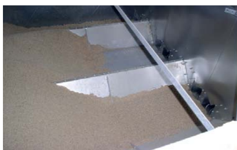
Caniveau de ventilation à faîtière installée
