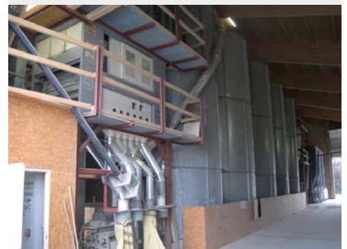
Système avec 4 000 t de stockage et nettoyeur vibrant
