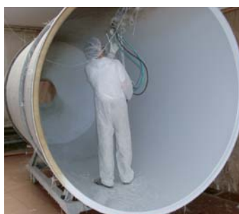
Production de silos PRV
