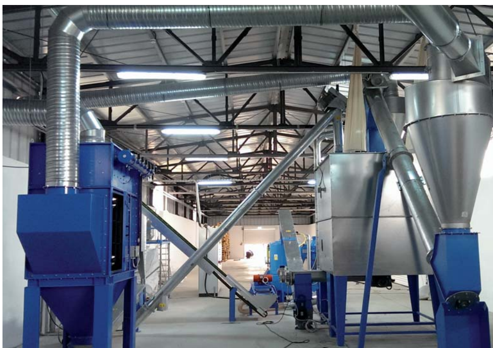
Filtre pour air comprimé dans une usine de production de granulés HIMEL
