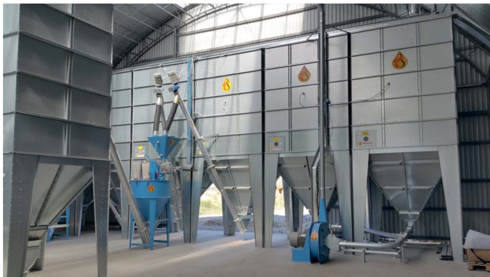
Fabrique d'aliments avec boisseau 60° comme silos à composants
