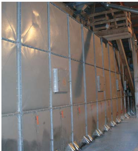
Silo de stockage rectangulaire avec trappe de vidange pour la fosse de réception
