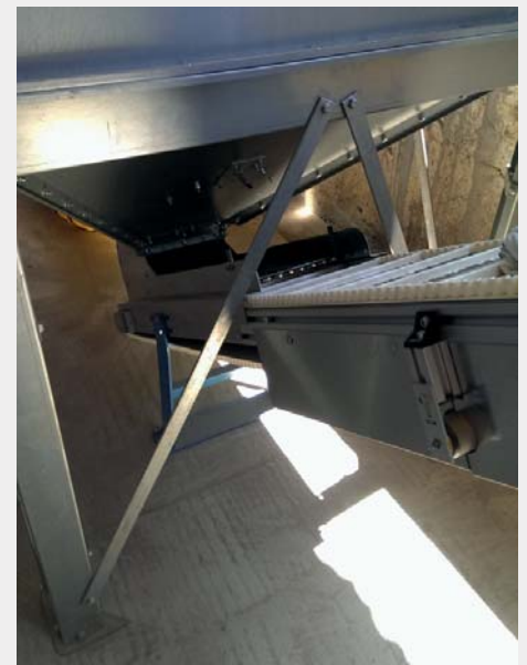
Convoyeur à bande, décharge silo d'aération
