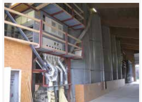
Anlage mit 4000 to. Lager und Siebreiniger
