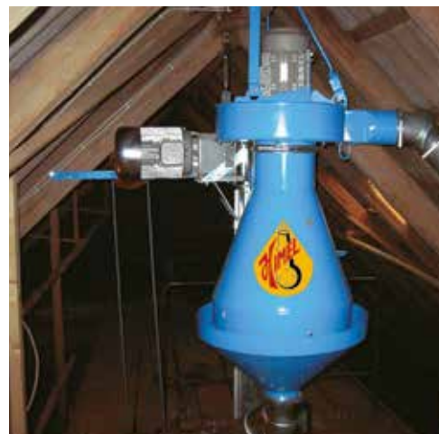
Vorreiniger in Anlage integriert
