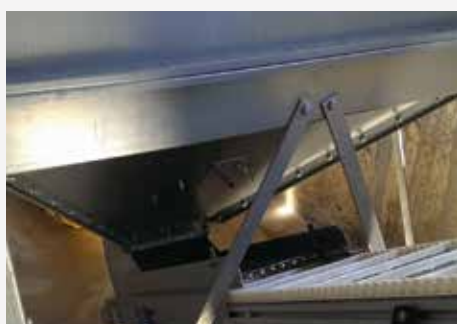
Förderband, Austrag Kühlsilo
